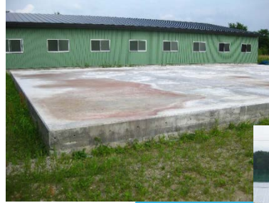
遮断型最終処分場
